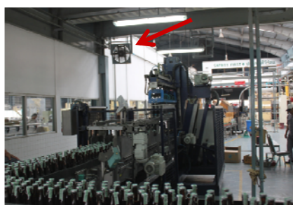
รูปที่ 4-36 การติดตั้งพัดลมระบายอากาศในอาคาร
